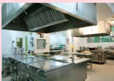
食品厨房設備
